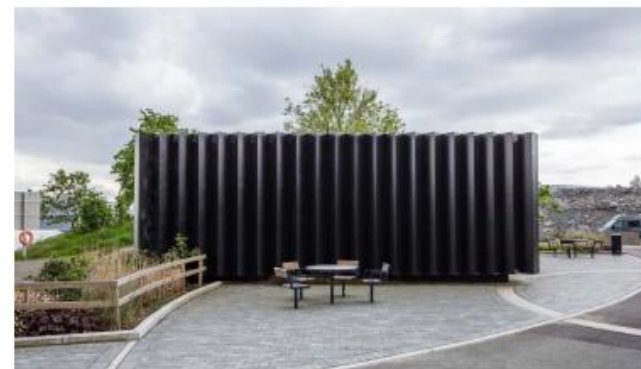
Trafo med en tilpasset utforming og materialbruk. Foto: Ghilardi + Hellsten Arkitekter
